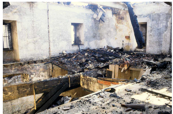
Quanto rimasto dell'edificio a seguito dell'incendio
